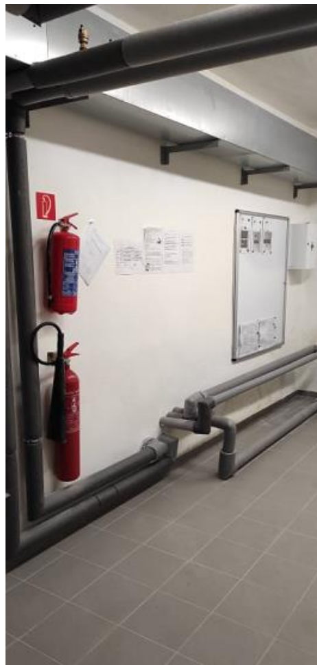
Kotolňa po rekonštrukcii
